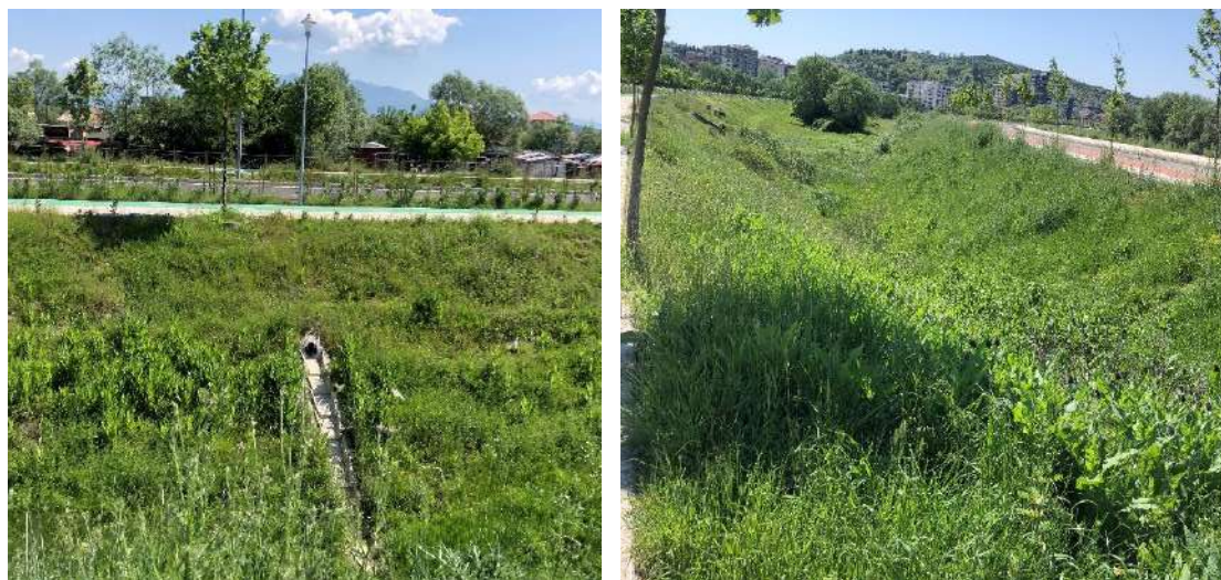
Figura 1-11 Pellgu 1 dhe tubat e drenazhimit që shkarkohen nga Bypass-et sipër.
