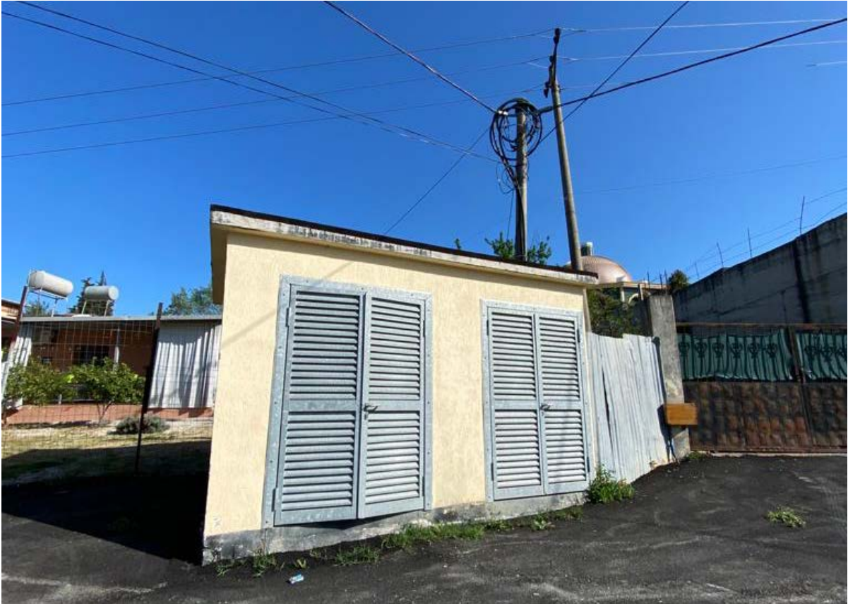
Kabina ekzistuese “Kryegjyshata 3”, fideri Fideri C6 (20kV), N/St Traktora
