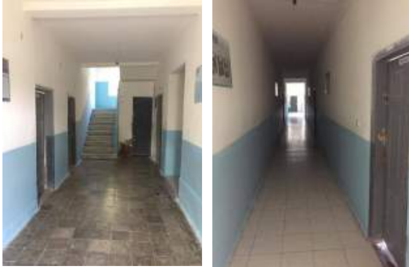
Figure 5 Gjendja ekzistuese e shtrimit të korridoreve të shkollës
