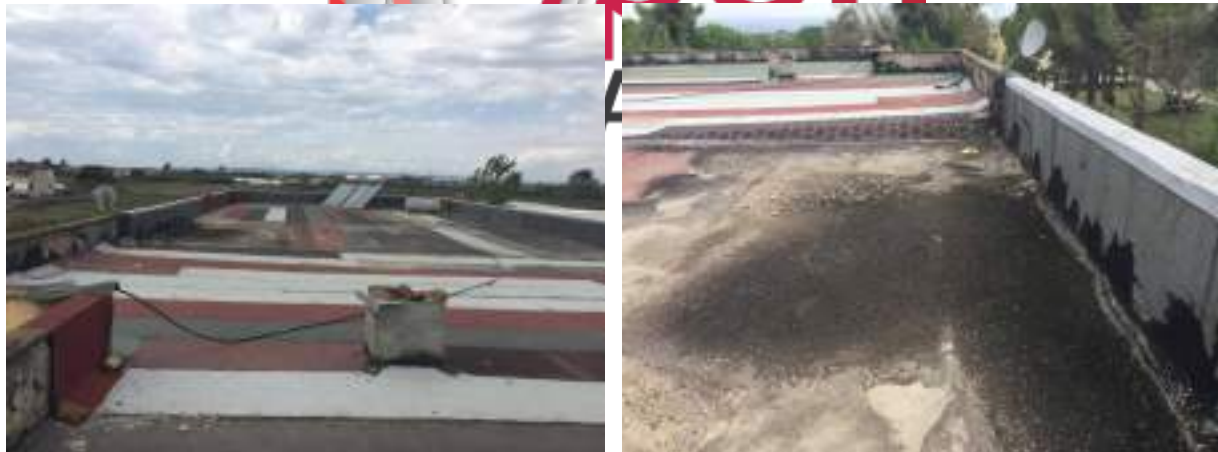
Figure 3 Gjendja ekzistuese e tarracës së godinës së shkollës
