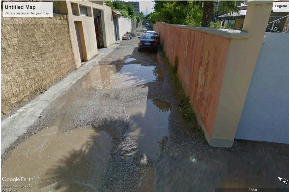
FOTO 2. Gjendja e rruges
