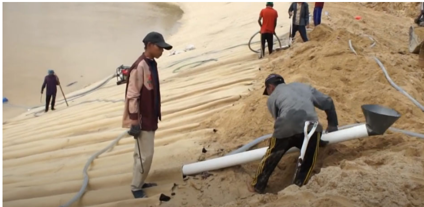
Figura 41: Instalimi i tubit që futet në hapësirën e brendshme të krijuar ndërmjet dy shtresave të gjeomembranës.
