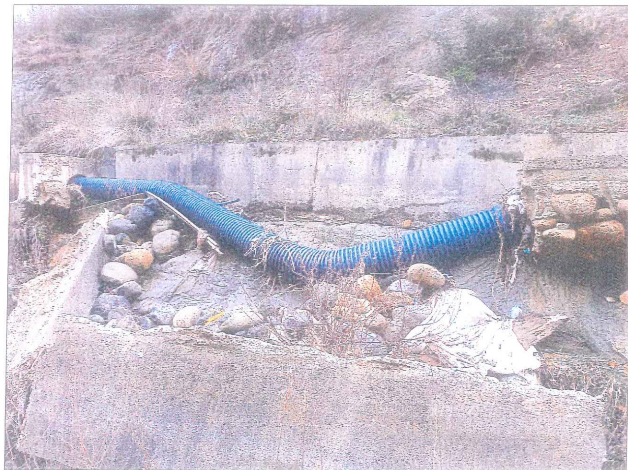
Tub i demtuar ne kanal
