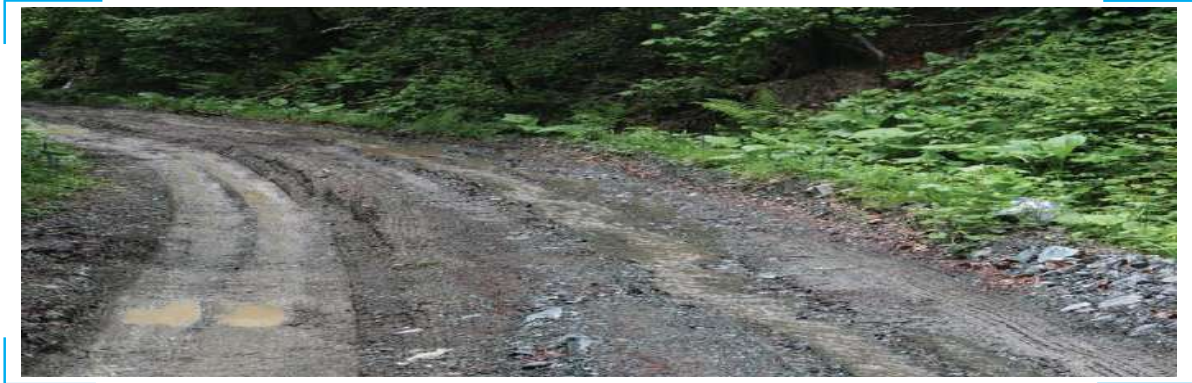
Fotografia 13 : Vraga e rrotave në rrugë si rezultat i kamionëve të stërngarkuar që lëvizin në rrugë me sistem jo të duhur drenazhimi dhe me kapacitet bartës të pamjaftueshëm të shtresës
