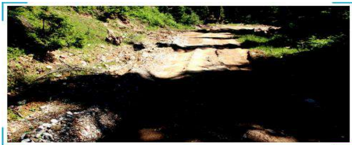
Fotografia 7: Erozioni sipërfaqësor në terren të rrëpirët (Fotografia: Juri Beguš)
