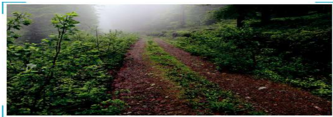
Fotografia 4: Anësoret rrugore me pastrim jo të duhur të vegjetacionit (Fotografia: Juri Beguš)
