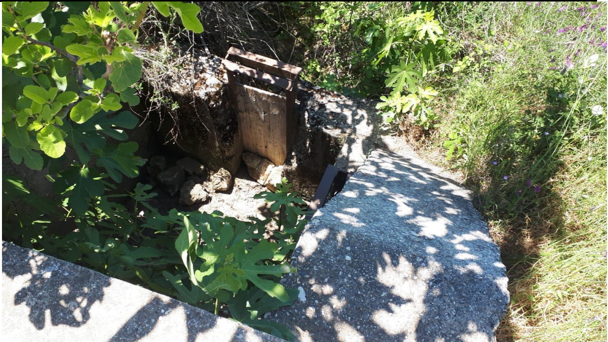
Fig.12 Pamje nga gjendja e portes ne hyrje te kanalit
