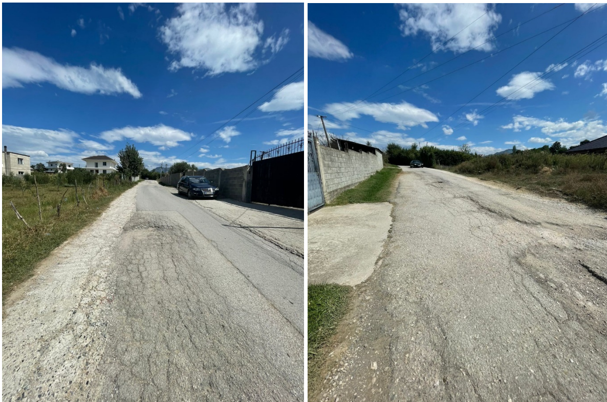
Figure 27 Cedim dhe degradim asfalti
