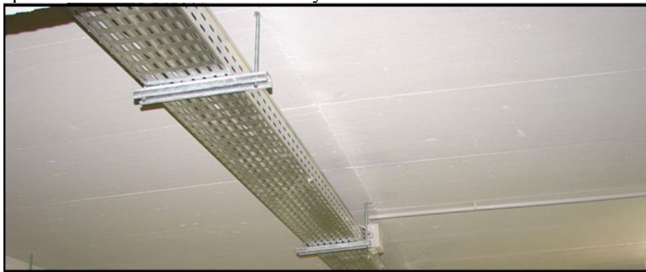
Kanalina metalike per magjistralet e linjave elektrike
