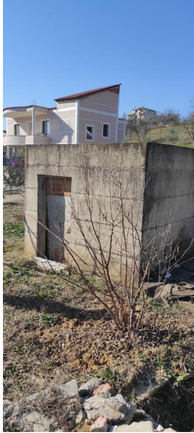
Puseta e shkarkuesit DN1200mm poshte Impiantit Boville, Koder Kuqe
