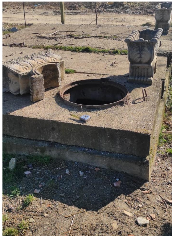
Puseta e kolektorit DN1000mm Koder Babrru
