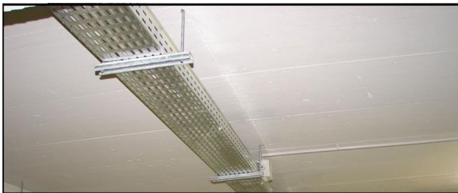
Kanalina metalike per magjistralet e linjave elektrike
