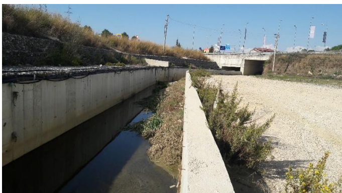
Kanali ku derdhet përroi Kallmit, pothuaj tërësisht i bllokuar
